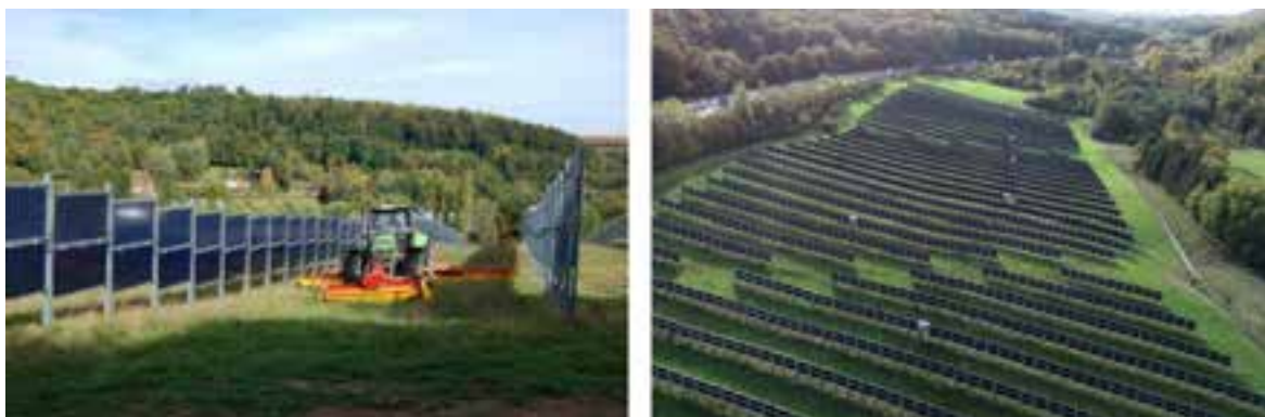
Fig. 42 - Moduli installati verticalmente. Fonte Fraunhofer ISE 28 .
