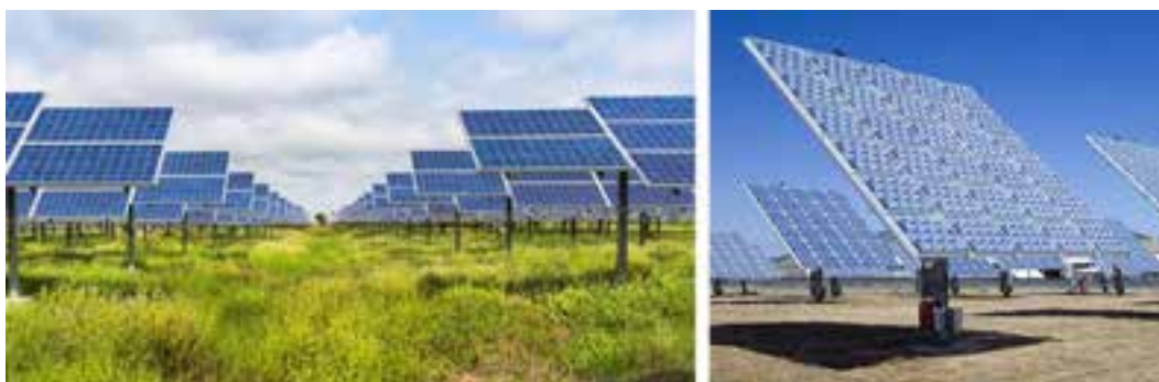
Fig. 45 – Immagini relative all'installazione a terra di inseguitori solari.
