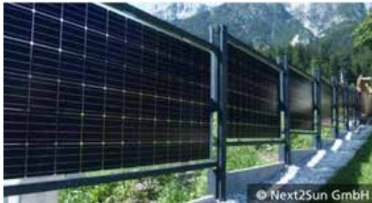
Fig. 44 - Moduli installati verticalmente. Fonte: Fraunhofer ISE.
